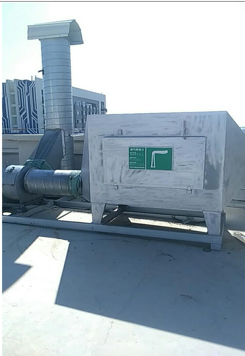
图 3.3 废气处理设施
